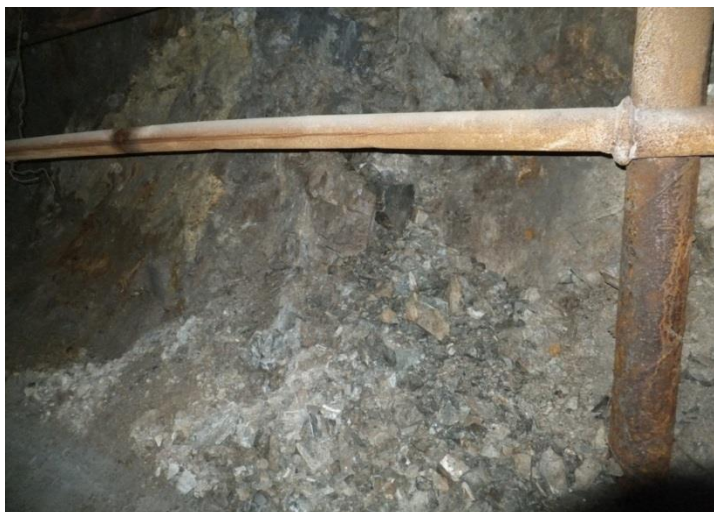
Рис. 3. Вывалы комбинированно-формирующиеся деформации сети трещин разорванная.
