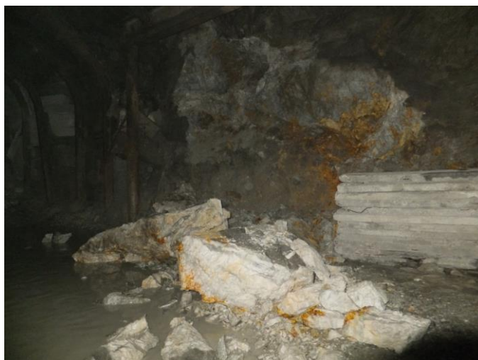
Рис. 2. Обрушение в кварцевых порфиритах: деформация, приуроченная к трещинам на пластования прерывистая на правой стенке.
