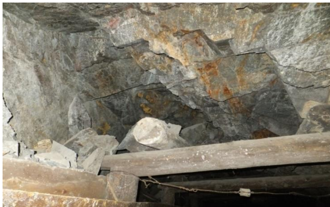
Рис. 1. Обрушения туфа- андезита в кровле горных выработок с захватом левой стенки, характер обрушения крупно-глыбовые сети трещин, полигональный.
